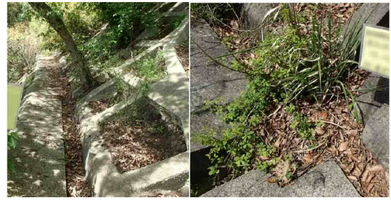
(a)水路閉塞 (b)集水樹閉塞 図6 法面水路工の閉塞の実態
